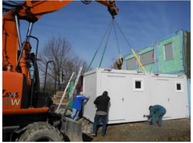
und des zweiten Sanitärcontainers
