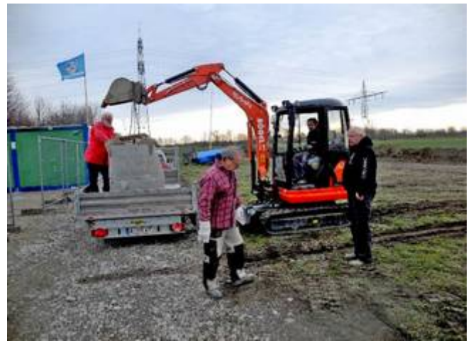
SCA-Versorgungsschacht: Alf Eckehard Erwin (KSC)
